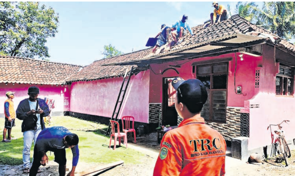
TRC BPBD Bantul melakukan evakuasi rumah penduduk yang rusak terdampak gempa.
