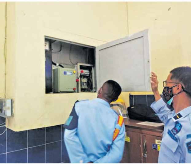
Petugas Rutan Wates sedang mengecek instalasi listrik.
