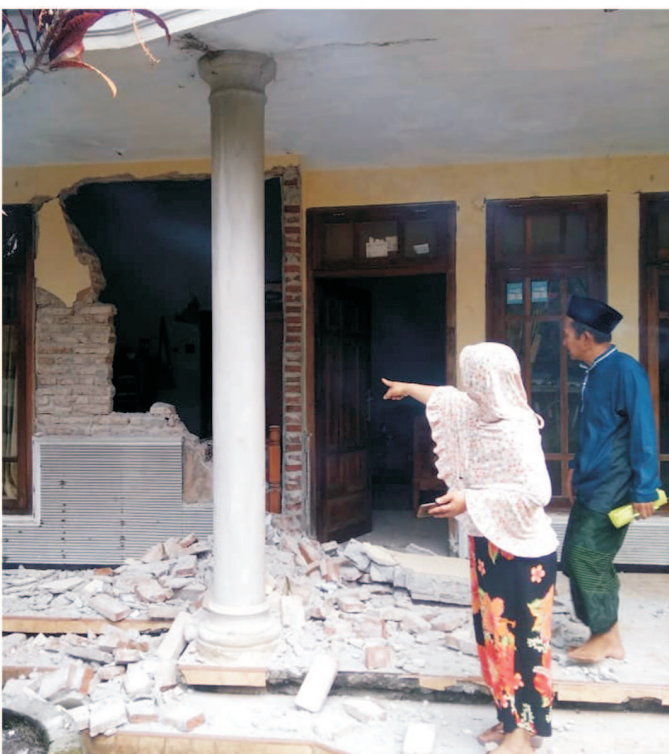
Rumah rusak akibat gempa di Kecamatan Turen Malang.
