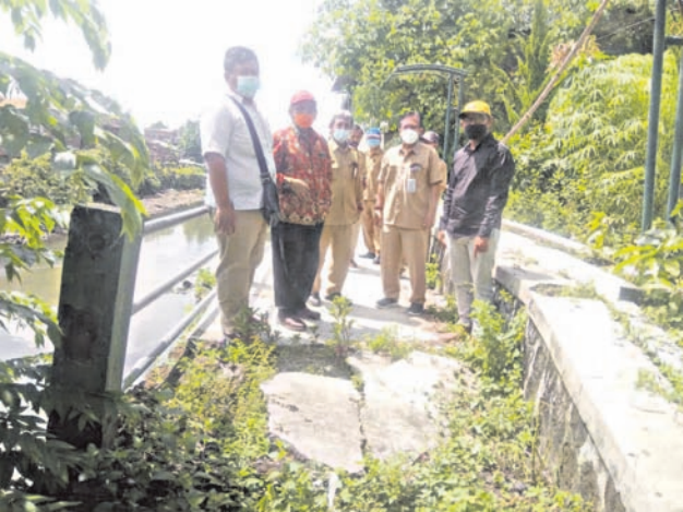
Komisi C DPRD DIY saat meninjau kerusakan talut di Wirobrajan.
