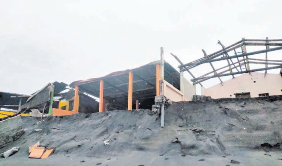
Bangunan rusak akibat diterjang gelombang pasang.
