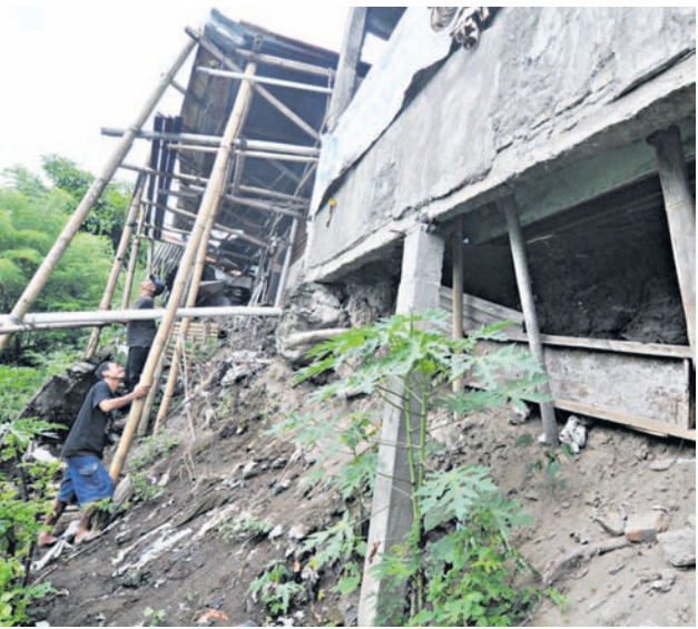
Tanah di bawah rumah warga yang terkikis akibat talut ambrol.
